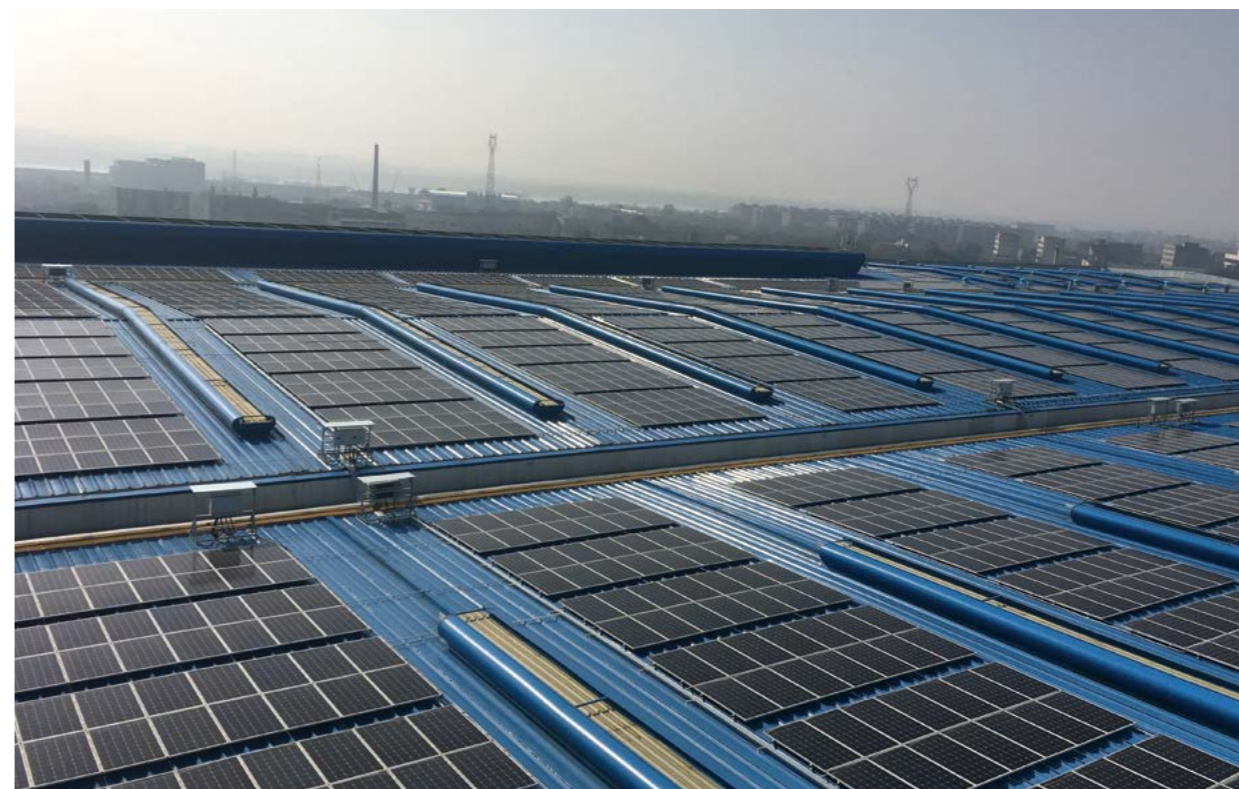
装备子集团光伏发电示范工程
