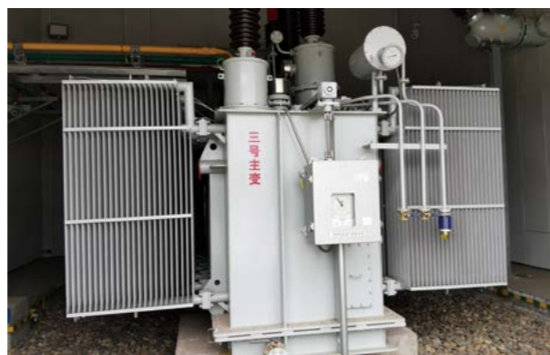
110KV声光电专用站
